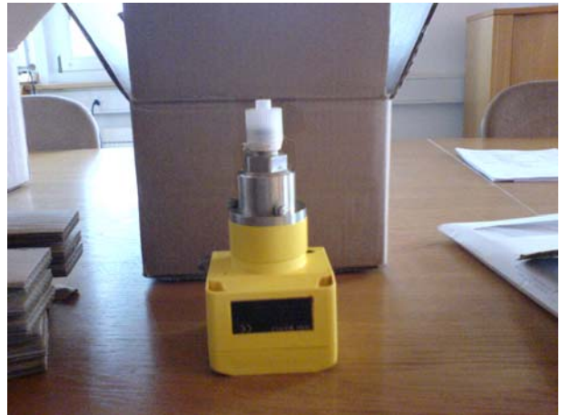
defekte Druckmessung HD-Tank
