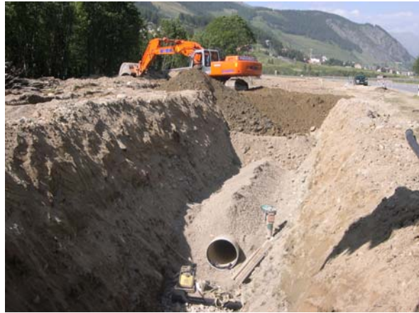
Zone mit schlechtem Baugrund beginnt vor Querung Val Greva
